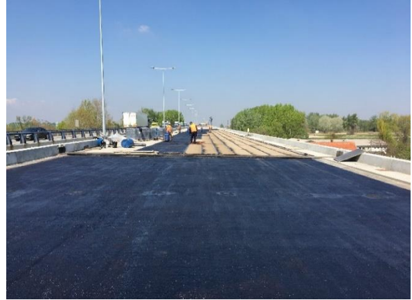
Слика 4. Дел од мостовска коловозна конструкција премачкана со прајмер Извор: Мост Остружница, Белград
