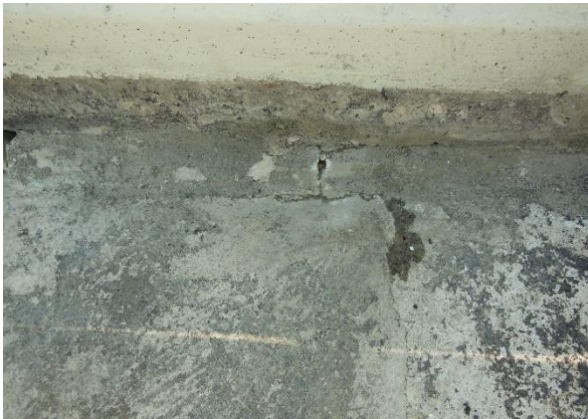
Слика 1. Нерамна и неисчистена бетонска подлога Извор: Слика од градилиште
