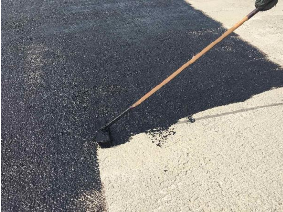
Слика 3. Премачкување со битуменски прајмер на бетонска подлога на мост Извор: Слика од градилиште
