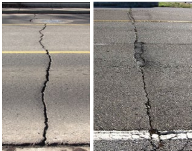
Слика 3. Лошо изведен попречен асфалтен спој Извор: https://roadresource.org
