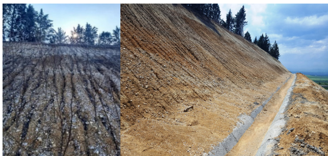
Слика 1: Инженерски косини со изразена ерозија, извор: Автопат Миладиновци – Штип
